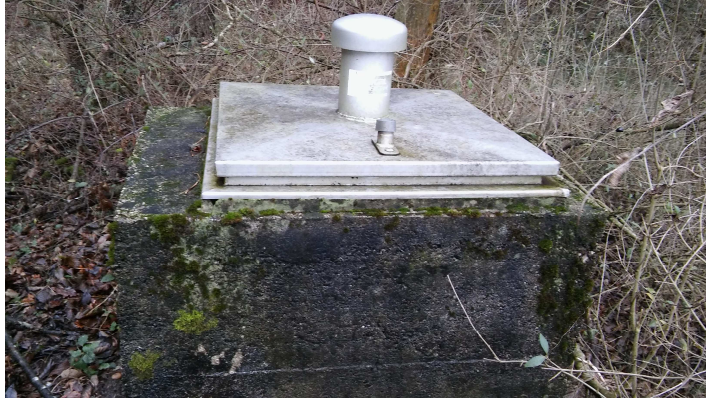
Quellsammelbehälter Quelle 1 und Quelle 2
